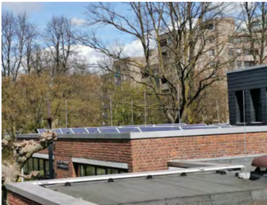
Photovoltaik an der Versöhnungskirche
